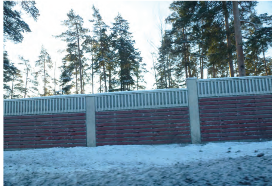
Kuva 2.9. Meluseinä Hollolan keskustajaksolla. Meluseinän julkisivun ehostaminen sekä muuttaminen osittain läpinäkyväksi parantaisi katuympäristön laatua sekä mahdollistaisi näkymät alarinteeseen.
