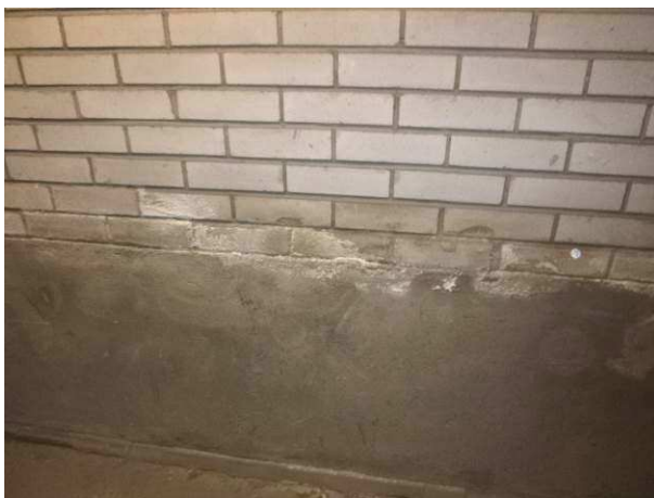
Kuva 7. Autohallin seinän kosteusjälkiä
