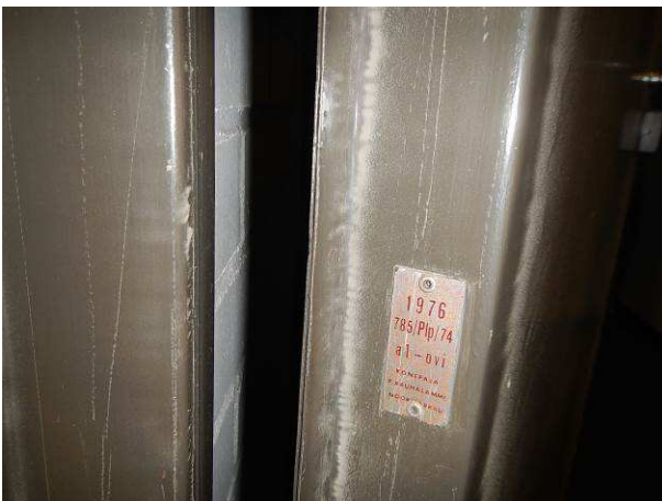
Kuva 3. Palo-ovien eristeissä on todennäköisesti asbestia
