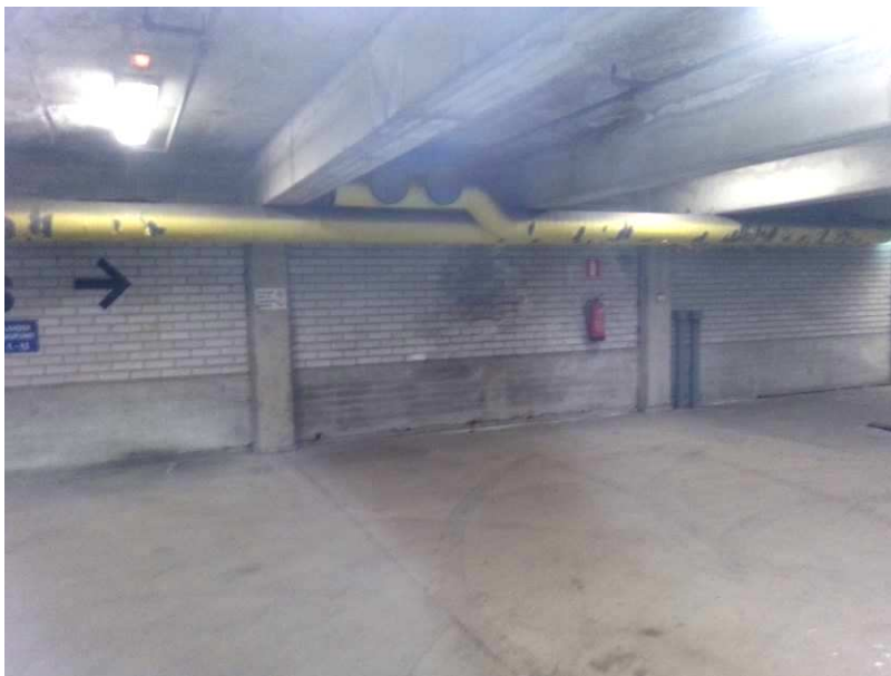
Kuva 4. Autohallin seinissä havaittiin kosteusjälkiä
