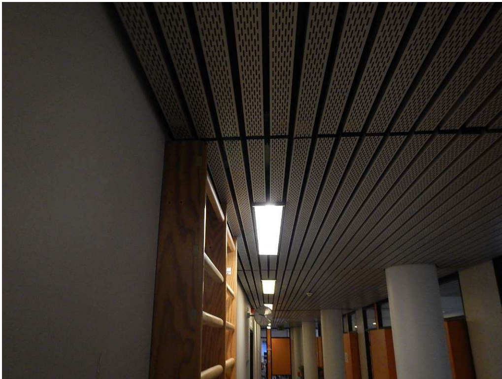
Kuva 3. Kohteen yleisvalaisimina on käytetty loisteputkivalaisimia
