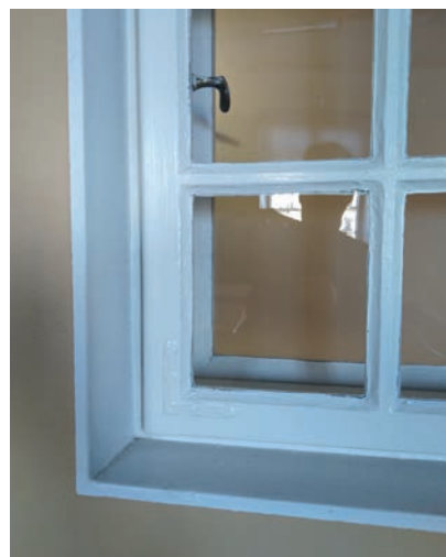
KUVA 199 ▲ Laajennusosan sisään 1952 jääneet alkuperäiset ikkunat ovat erinomaisessa kunnossa.
