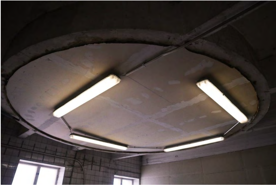
Kuva 108. Väliohjan pyöreä aukko, jossa on ollut sillo.
