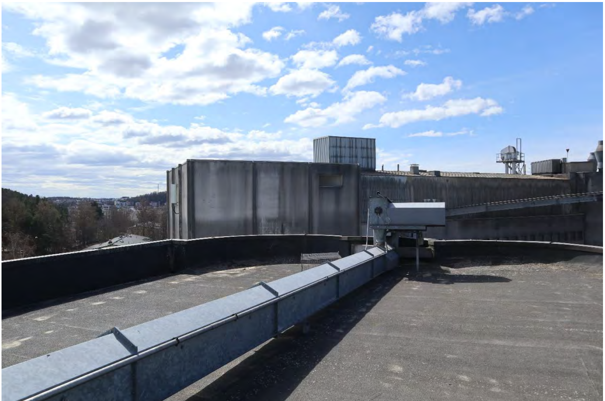
Kuva 141. Kuva S2:n katolta, jossa näkyy sinne sijoitettu putkisto, joka liittyy myös muihin rakennuksiin.
