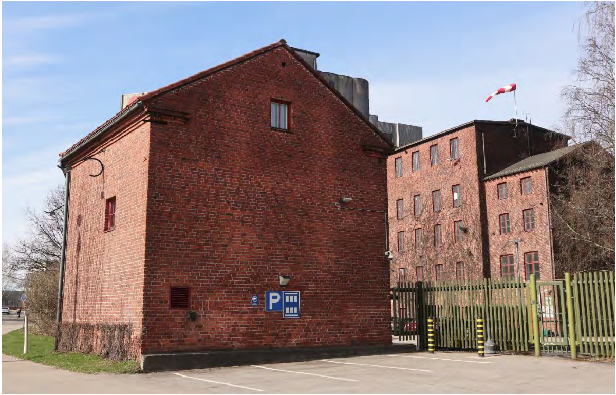
Kuva 72. Makasiinirakennuksen pohjoisjulkisivu Niemenkadun suunnalta nähtynä. Rakennuksen päätyjulkisivussa on yksi ullakkoikkuna, kissanpenkit sekä tekniikkaan viittavia läpivientejä. Puhtaaksi muuratun tiilen lisäksi hieman ulkoneva kivisokkeli ovat merkittäviä ulkoarkkitehtuurin piirteitä.
