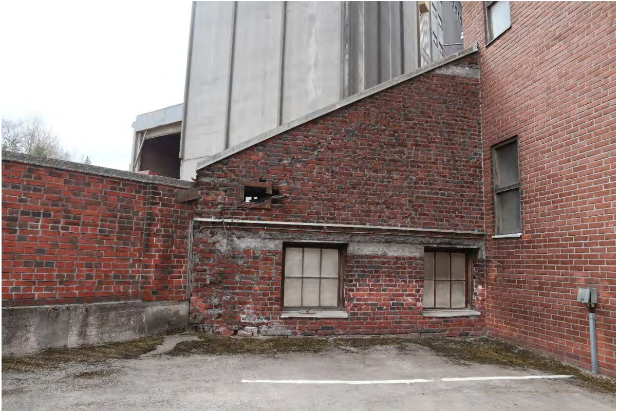
Kuva 138. S1:n itäpuoli. Oletettavasti vanhasta mallastamosta on jätetty eteläjulkisivu, joka nyt toimii tehtaan muurina. Oikealla näkyy uudemman muurirakenteen liittyminen kyseiseen kohtaan. Ikkunoiden lisäksi ylempänä näkyy umpimuuratun ikkunan yläpuolinen muuraus sekä mahdollisesti rakennuksen harjalinja.
