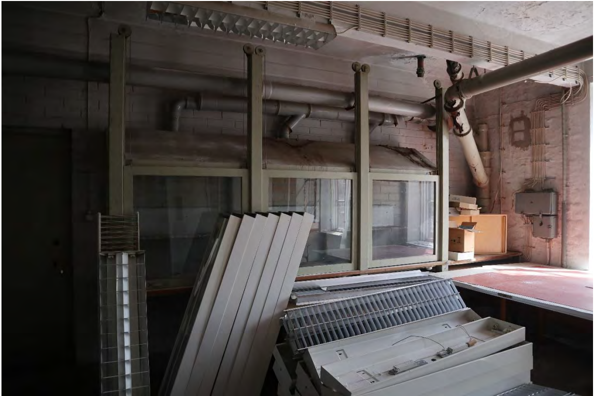
Kuva 111. Hiivatehtaan toisen kerroksen laboratoriotilan vetokaapit.
