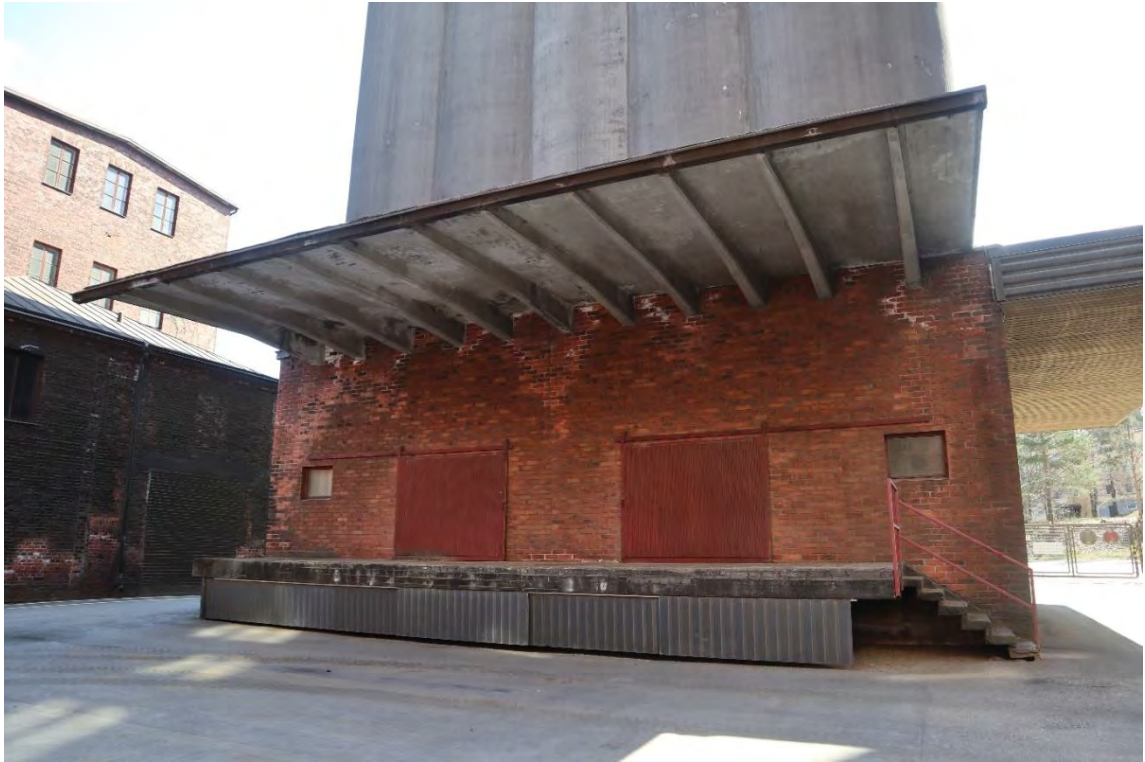
Kuva 136. Siilo S2:n länsijulkisivu. Alin kerros on toteutettu tiilisenä ja sylinterimäiset siilot on toteutettu liukuvaluna. Sekä länteen että etelään on sijoitettu betonirakenteiset katokset. Länsijulkisivulla on myös betoninen lastauslaituri ja portaat.
