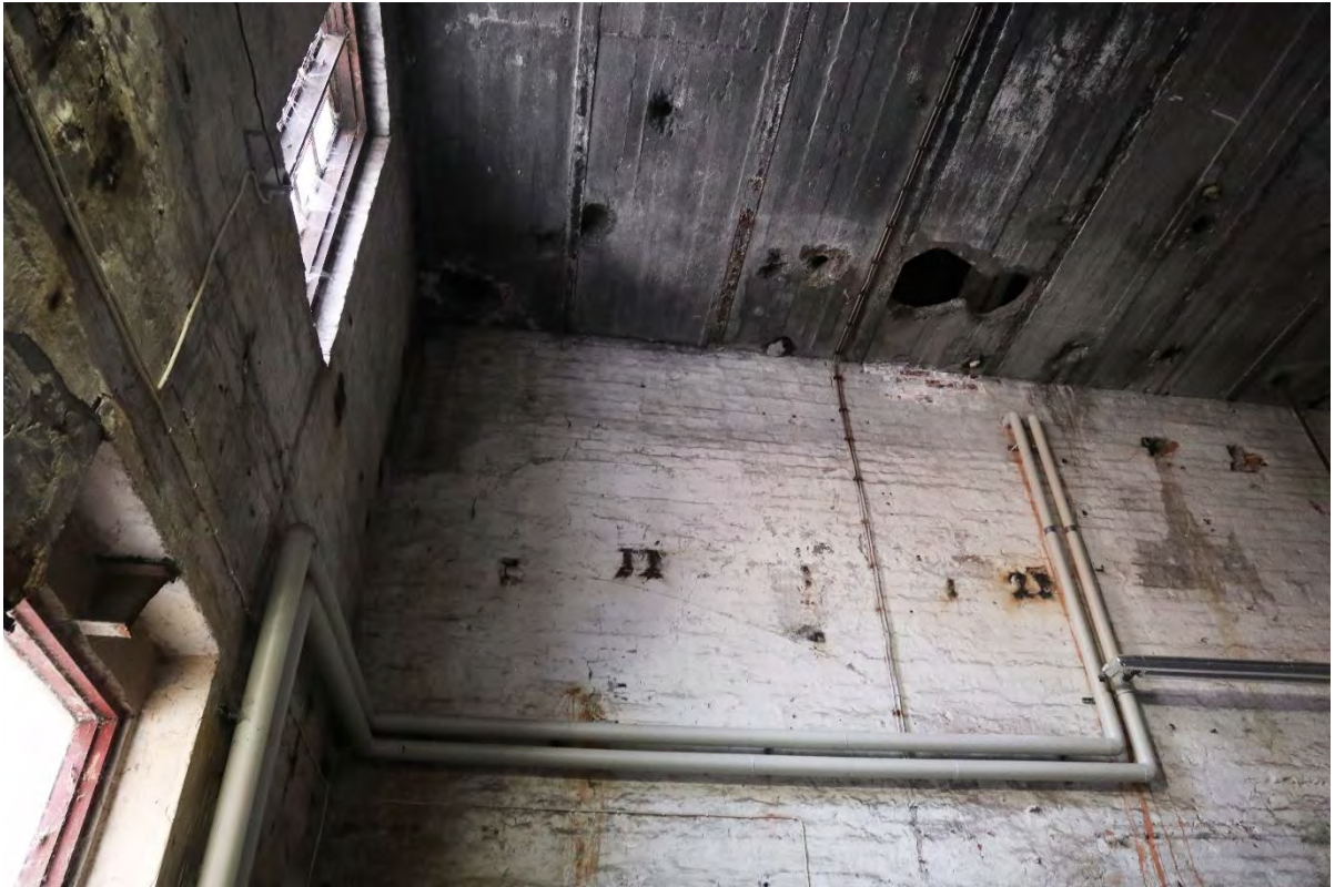
Kuva 102. Kattilahuoneen yläpohjan alapinta on valettu betonista, jossa näkyy reikä. Vasemmalla näkyy idän puoleinen seinä.
