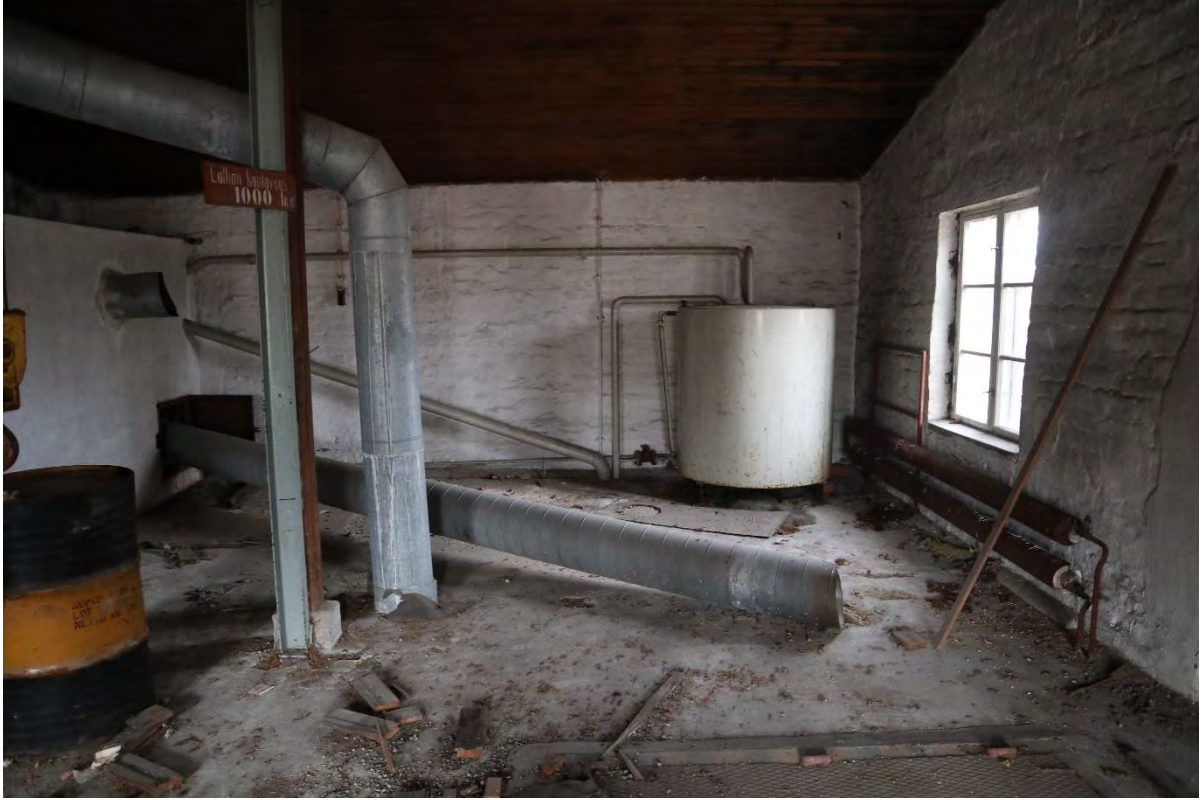
Kuva 124. Hiivatehtaan pohjoispäädyn ylin kerros. Vasemmalla etualalla näkyy välipohjan luukku. Kuvan ulkopuolelle oikealle jää oviaukko ja nostinrakenteen palkki.
