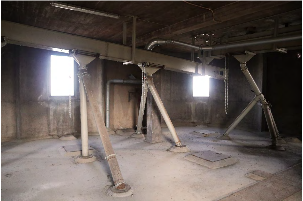
Kuva 153. S2:n ylimmässä kerroksessa sijaitsevat siloston täyttöön liittyvä laitteisto putkineen.
