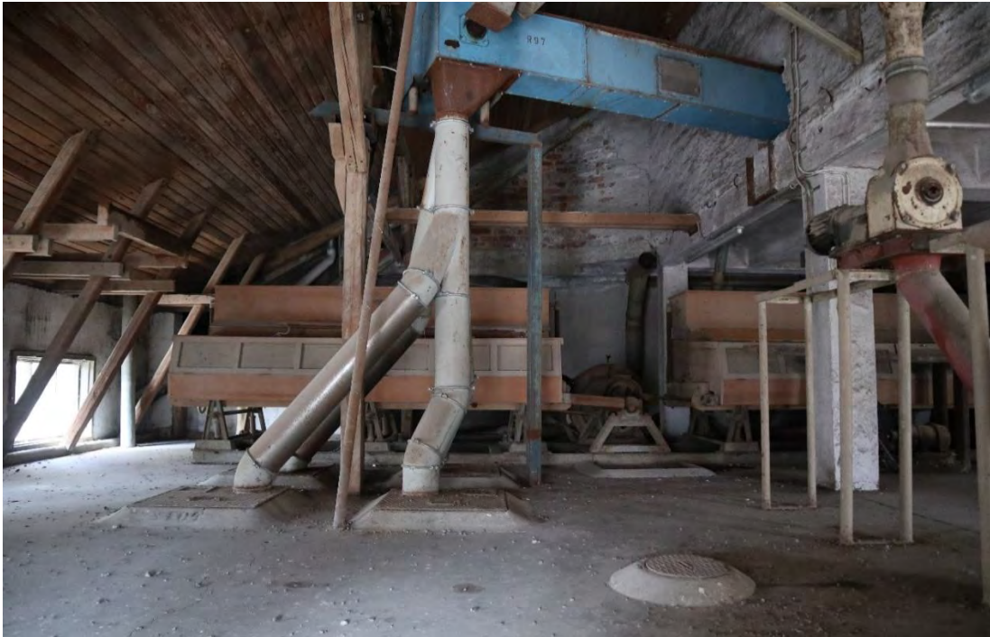
Kuva 149. S1:n ylimmän kerroksen ylätaso ja silloston yläpuolista tekniikkaa sekä silloihin johtavat huoltoluukut lattiassa.
