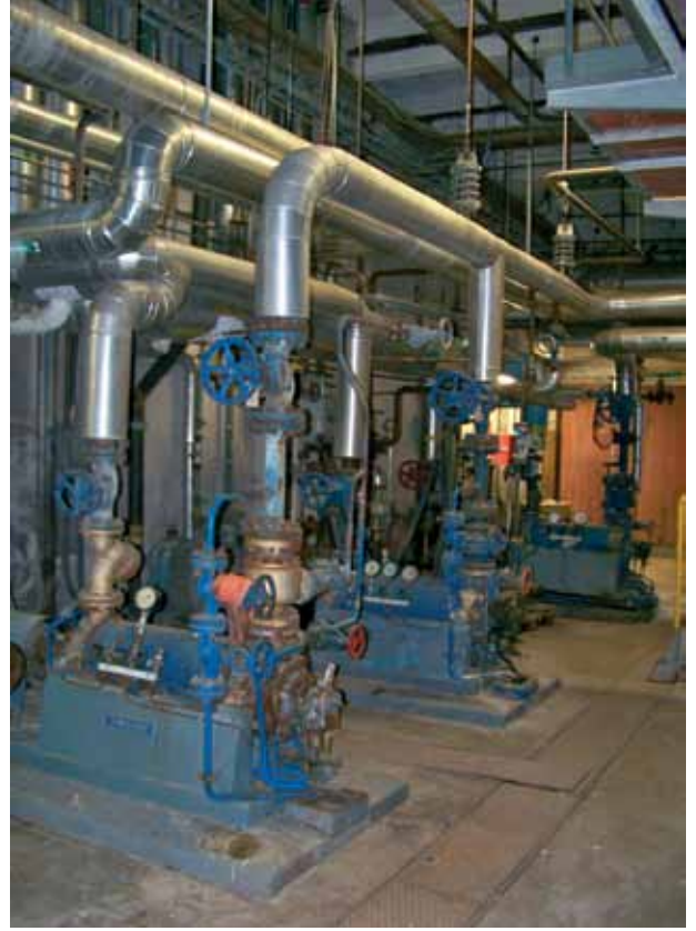
Kattilahuoneen pumppuja (JL 2010).
