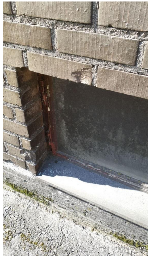
KUVA 19. Pohjoissivun siilo 2 -rakennuksen julkisivuvauriot
