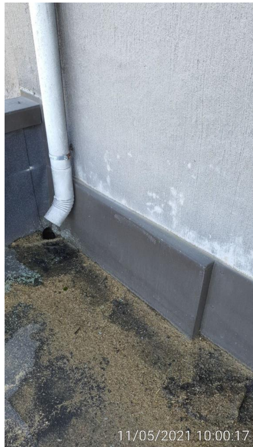
KUVA 17. Siilo 2 -rakennuksen porrastornin julkisivuvaurio.
