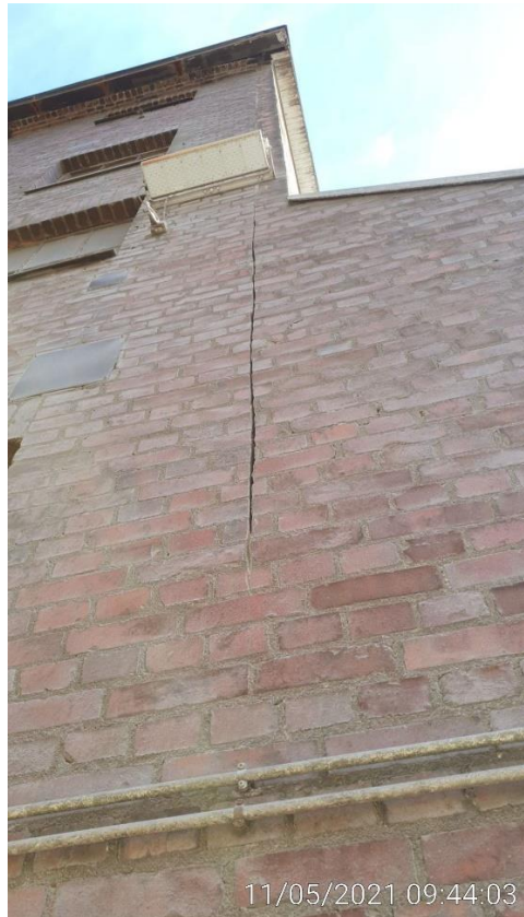
KUVA 21. Eteläisivun siilo 1 -rakennuksen julkisivuvauriot
