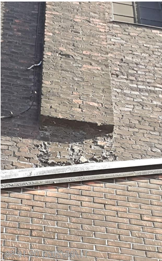
KUVA 18. Pohjoissivun siilo 1 -rakennuksen julkisivuvaurio
