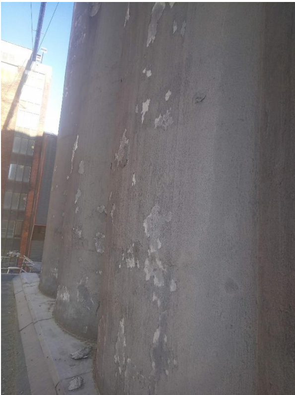
KUVA 14. Siilo 2 -rakennuksen julkisivuvaurio.
