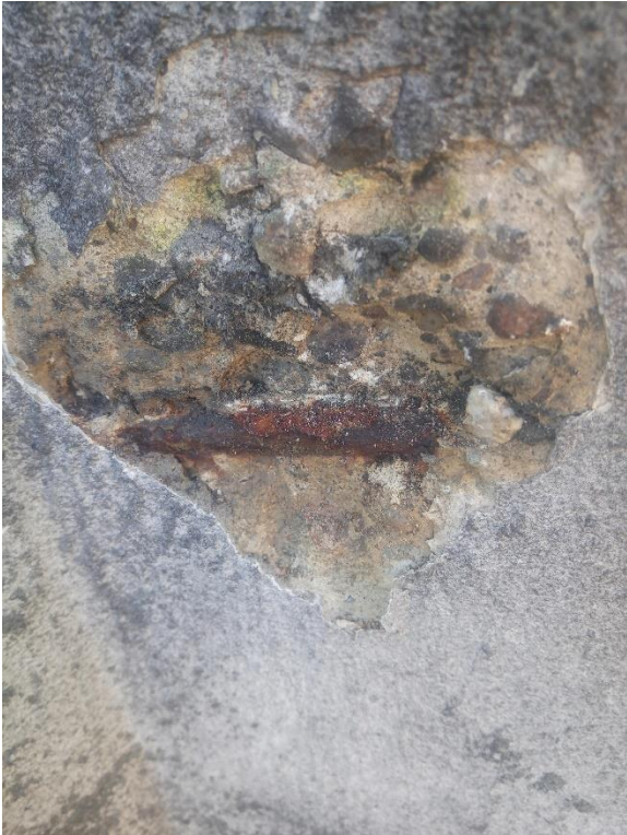
KUVA 12. Siilo 2 -rakennuksen julkisivuvaurio.
