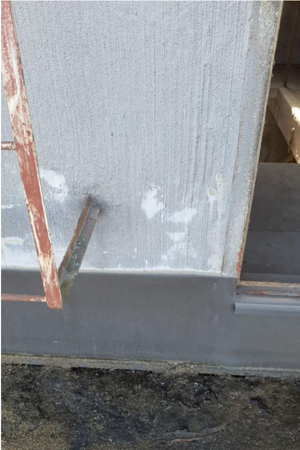
KUVA 16. Siilo 2 -rakennuksen porrastornin julkisivuvaurio.
