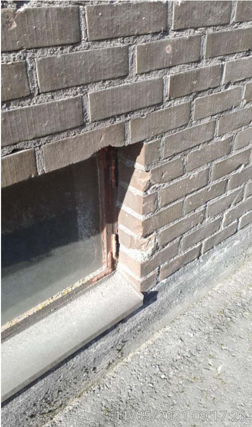
KUVA 20. Pohjoissivun siilo 2 -rakennuksen julkisivuvaurio
