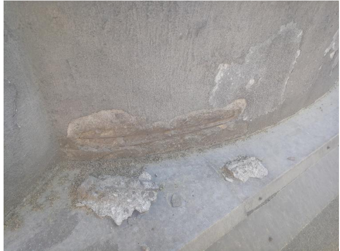
KUVA 13. Siilo 2 -rakennuksen julkisivuvaurio.
