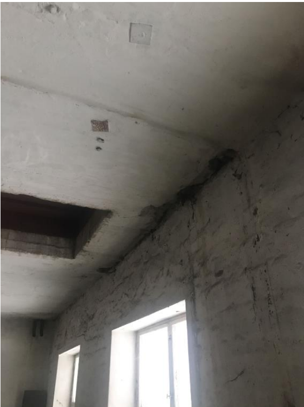
KUVA 7. 1. krs varasto. Halkeamia katon rajassa.
