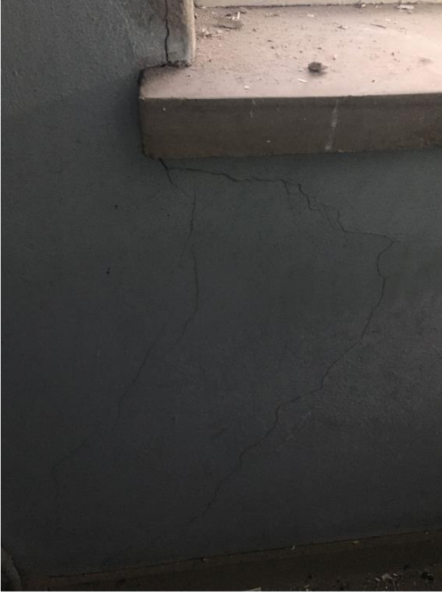
KUVA 29. 5 krs rappukäytävä. Halkeama ikkunan kohdalla.
