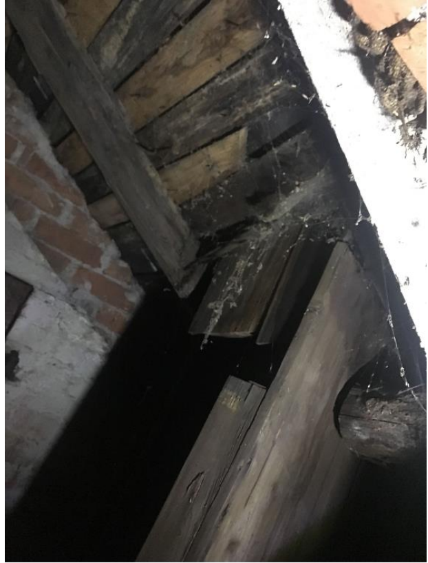
KUVA 22. 3. krs ullakko. Kattorakenne laho.
