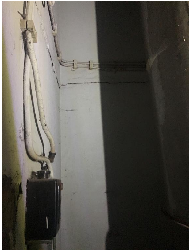
KUVA 20. 2. krs hiivalieteosasto. Halkeama seinässä.
