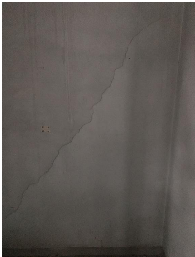
KUVA 24. 4. krs rappukäytävä. Halkeama seinässä.
