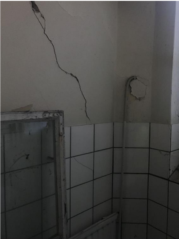
KUVA 15. 2. krs WC-tila. Halkeama seinässä.
