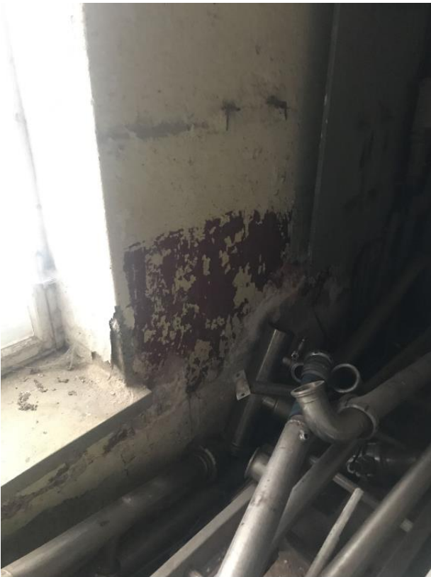
KUVA 11. 1. krs kompressorihuone. Maali on irronnut seinästä.
