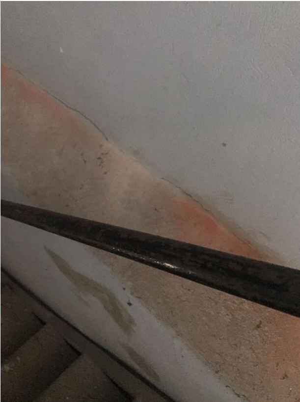
KUVA 27. 5. krs rappukäytävä. Halkeama seinässä.
