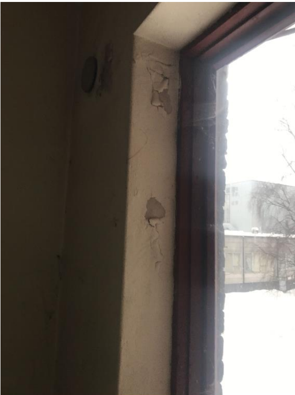
KUVA 19. 2. krs mallasosasto. Maali on irtoillut seinästä.
