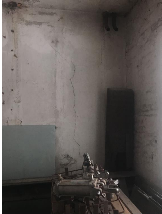
KUVA 6. 1. krs varaston seinä. Halkeama seinässä.
