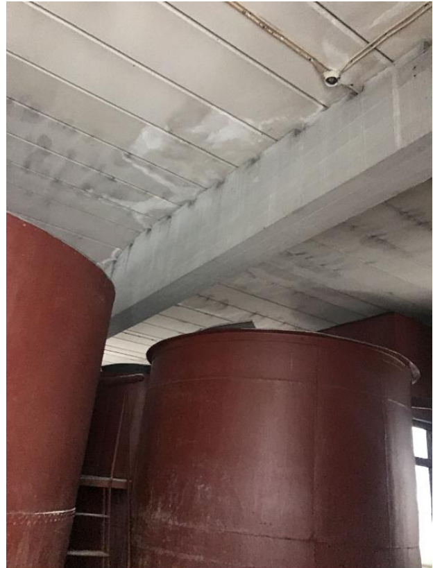
KUVA 28. 5 krs vesisäiliöhuone. Kosteusvuotoja kattorakenteessa.
