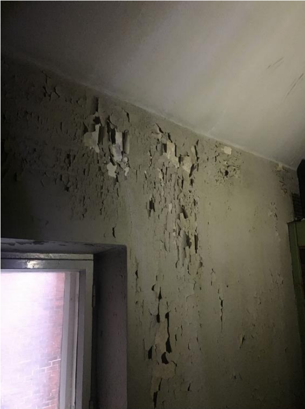
KUVA 21. 3. krs koemallastamo. Maali on irronnut seinästä.
