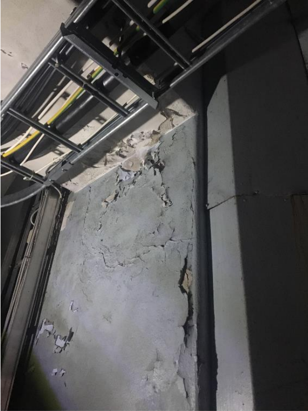
KUVA 13. 1. krs käytävä. Maali on irronnut seinästä.
