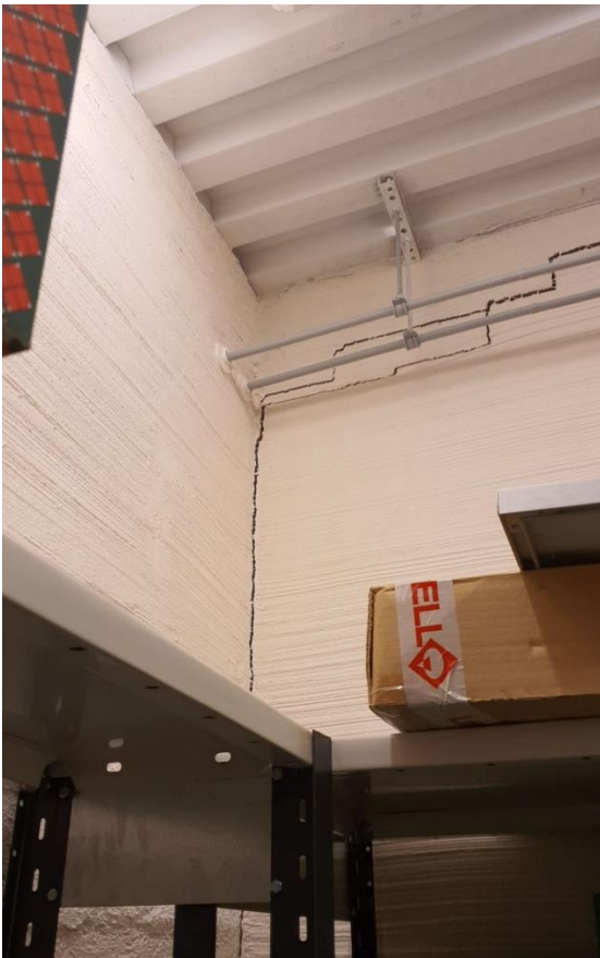
KUVA 14. Varaston poikittais- ja pitkittäishalkeama.
