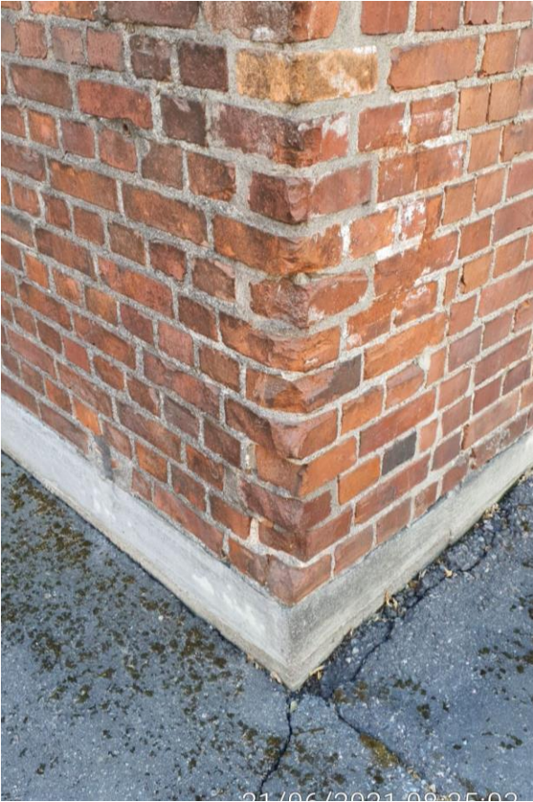
KUVA 16. Julkisivun lohjenneet tiilet.
