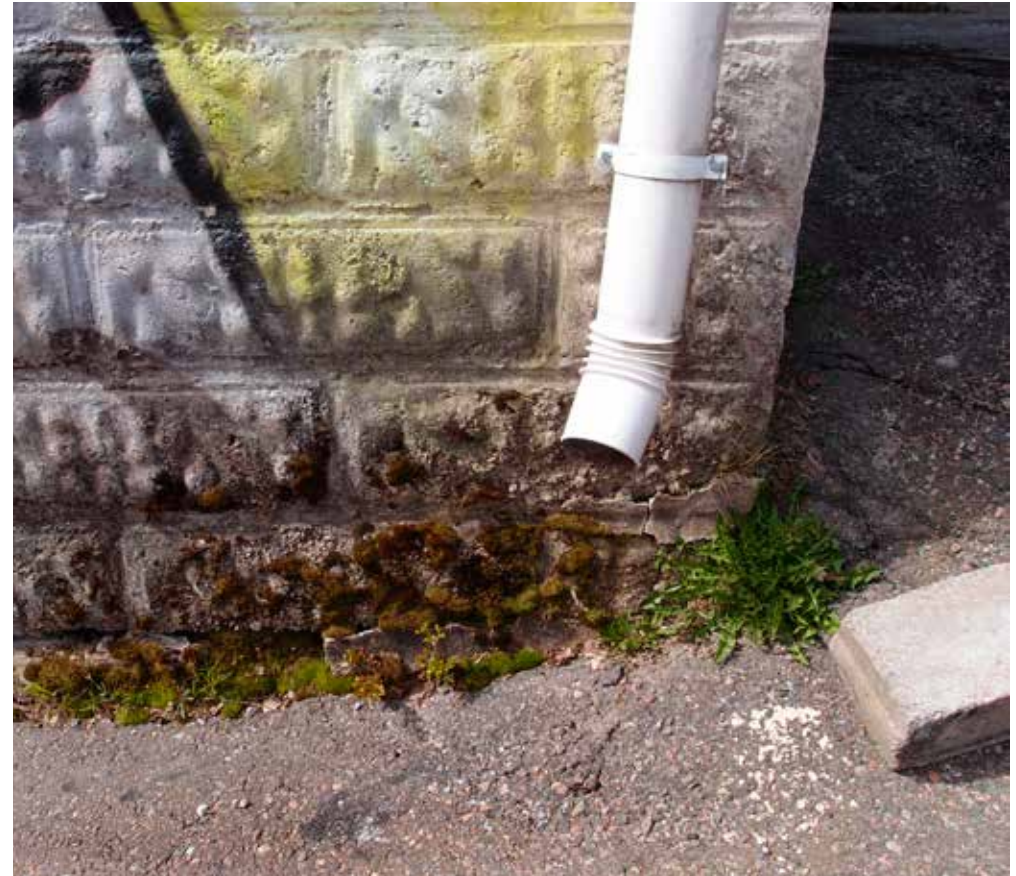
Kuva 75: Sadevesien poisto tontilla on järjestetty puutteellisesti, ja julkisivut molemmissa rakennuksissa ovat kärsineet paikoin vesirasituksesta. Kuvassa Möysänkatu 3 nurkka, jossa kattovedet johdetaan syöksytorvesta suoraan ulkoseinän juureen. Valokuvattu kohdekäynnillä 06.05.2024.
