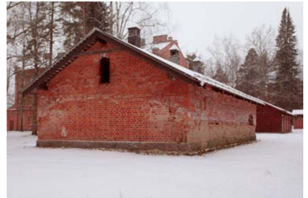
Venäläisaikaisen varaston (13) kulmissa näkyy halkeamia.
