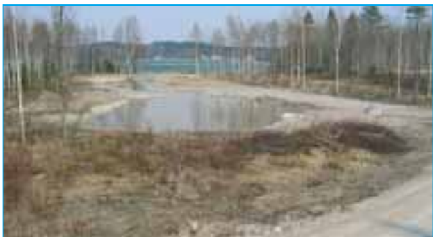
Kariston alueen rakentamisessa pyritään estämään hulevesistä Kymijärveen aiheutuvat rehevyyshaitat laskeutusaltaita ja kosteikkoja rakentamalla.
