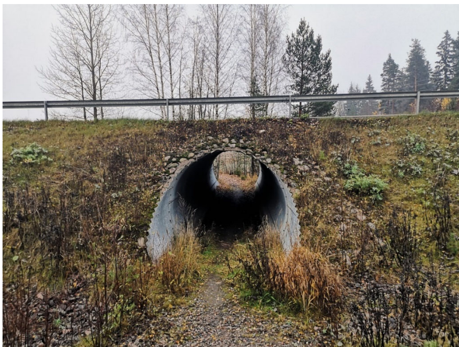
KUVA 7. Alikulkuputki Järvenpään ja Tuusulan rajalla palvelee niin ihmisiä kuin eläimiä (Carita Uronen).
