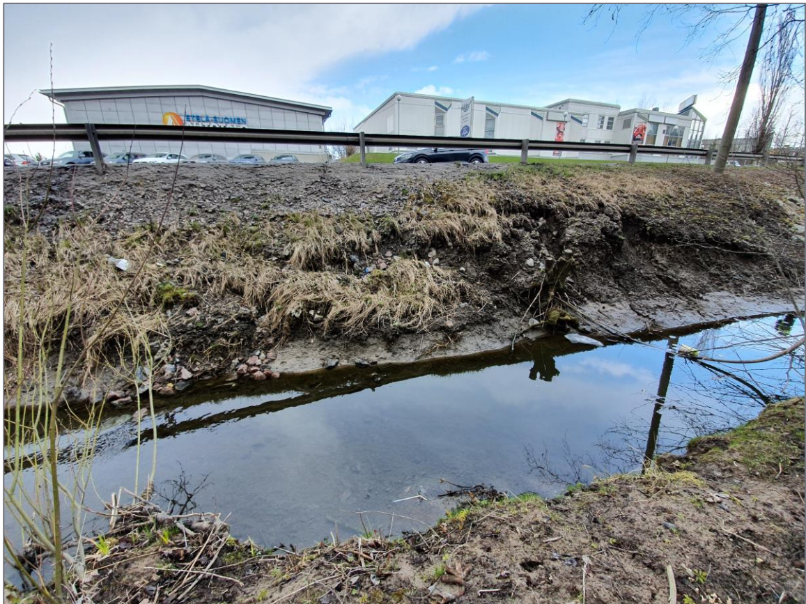
Kuva 5. Eroosiosta kärsinyt uoman reuna (kuva: Sitowise Oy).
