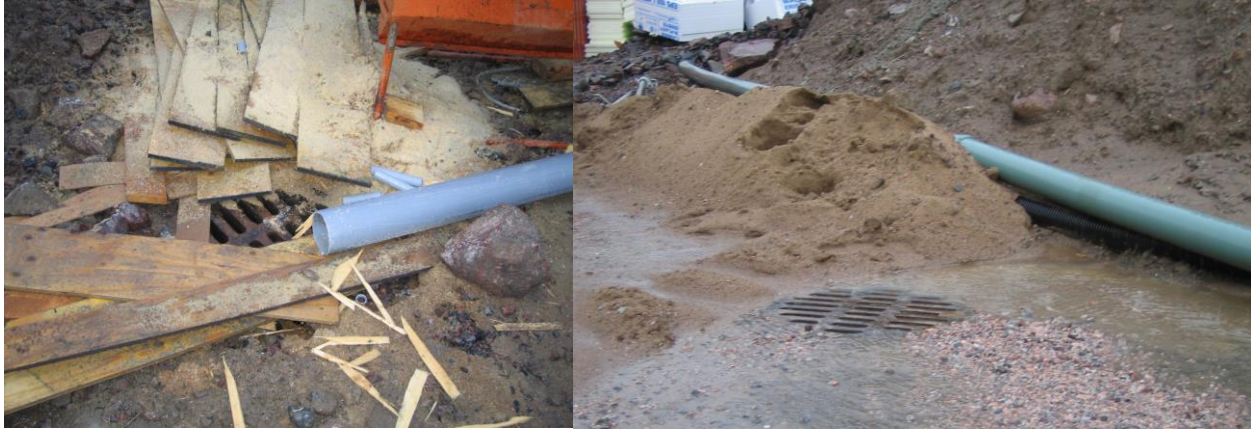
Kuva 6. Viemärinkannen päälle ja läheisyyteen sijoitetut rakennusmateriaalit tai -jätteet kulkeutuvat helposti viemäriin.
