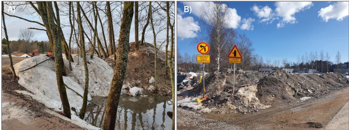
Kuva 4. Tilan puutteen vuoksi työmaan lumet on aurattu lähipuroon, minkä seurauksena suuri määrä kiintoainesta päätyy suoraan vesistöön – samalla läjitetty lumi ja siitä kulkeutuva kiintoaine aiheuttavat läheisen rummun tukkeutumisenriskin (A). Työmaan rakennusjätettä on kulkeutunut lumen aurauksessa lumikasoihin, joiden sulaessa haitta-aineita kulkeutuu lähiympäristöön (B). (kuvat: Sitowise Oy)
