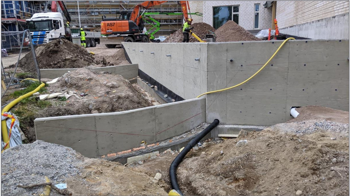
Kuva 3. Väärin sijoitettuja rakennusmateriaaleja ja jätteitä rakennustyömaan tulvareitillä. Etualalle ja vasemmalle on suunniteltu imeytyspainanne ja sen säännöstelyyn liittyvät patomuurit ovat rakenteilla. Painanteet olisi pitänyt esirakentaa toimintavalmiuteen jo rakentamisen alkuvaiheessa, eikä niiden alueelle saa varastoida rakennusmateriaaleja tai -jätteitä (kuva: Sitowise Oy).
